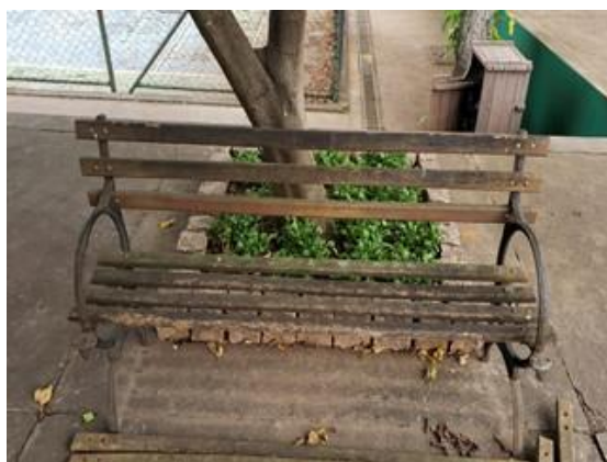
Figura 43: Banco antes da reforma
