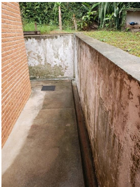
Figura 41: parede com pintura deteriorada
